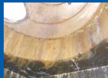
地震での目地ズレによる浸入水
